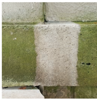
/// DESTRUCTOR SUR FAÇADE AU BOUT DE 10 MINUTES
