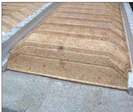
Pose de l'EBS en bout de travée avec bouchon incorporé. Toujours commencer par les extrémités avec les bouchons sur les arases
